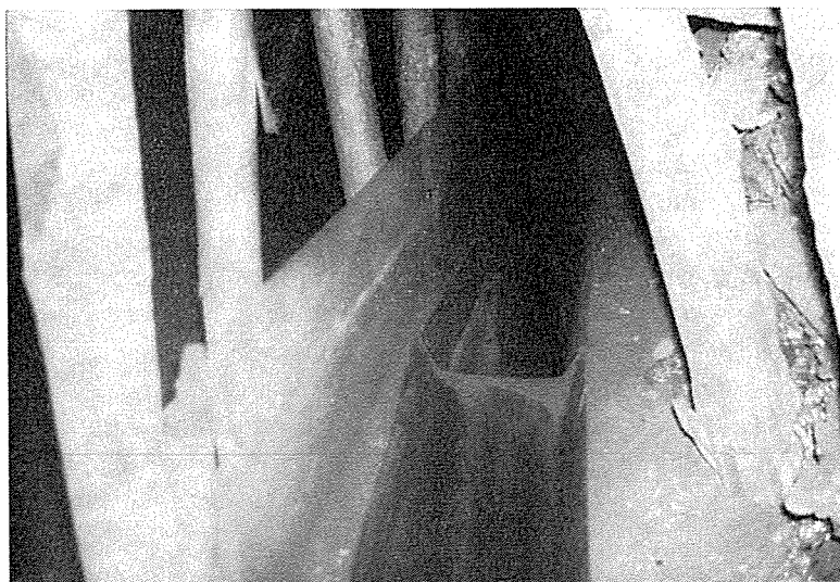
Aspecto dos «caleiros» que são assentes nos primários e secundários aquando da sua abertura e que conduzem o carvão até às tolvas; à esquerda, a protecção em tabuado e, para lá da mesma, a passagem de pessoal e materiais.
